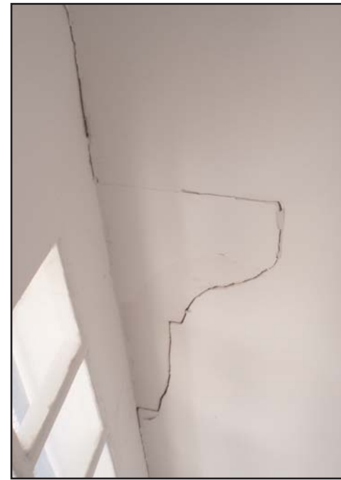
Fotografía donde se puede apreciar las dimensiones de las grietas existentes en las instalaciones de la redacción de este periódico en Casas Altas, el grosor de las mismas alcanza el centímetro. Si bien es necesario aclarar que antes del terremoto ya estaban pero se han hecho mayores tras el seísmo. Foto: J.L. Rodilla
