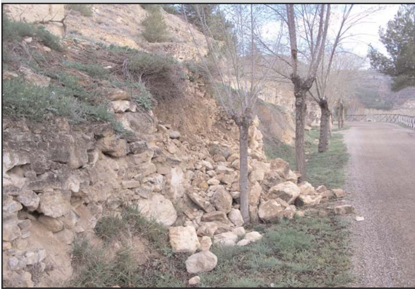
Portillo en Casas Altas (Camino Viejo de Ademuz) ocasionado por el terremoto. En las viviendas se aprecian nuevas grietas y a consecuencia del temblor varios objetos situados en estanterías o vitrinas se rompieron
